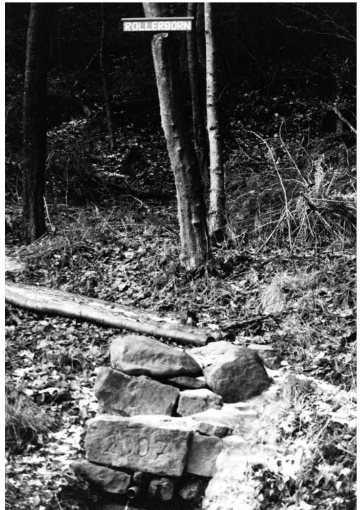
Der aus Sandstein von Mellnauern gefertigte Wasserauslass musste wieder entfernt werden
